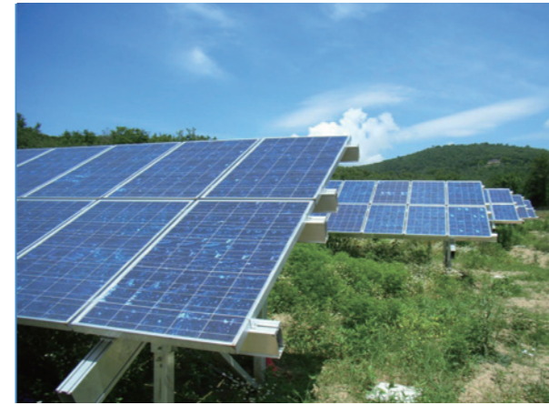
▪ Solar Power Station 太阳能发电站
